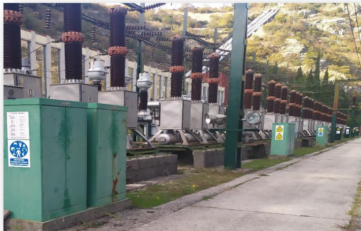
SLIKA 4 – VISOKONAPONSKO POSTROJENJE 110KV
