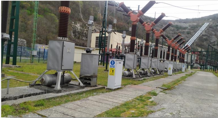
SLIKA 3 – VISOKONAPONSKO POSTROJENJE 220kV
